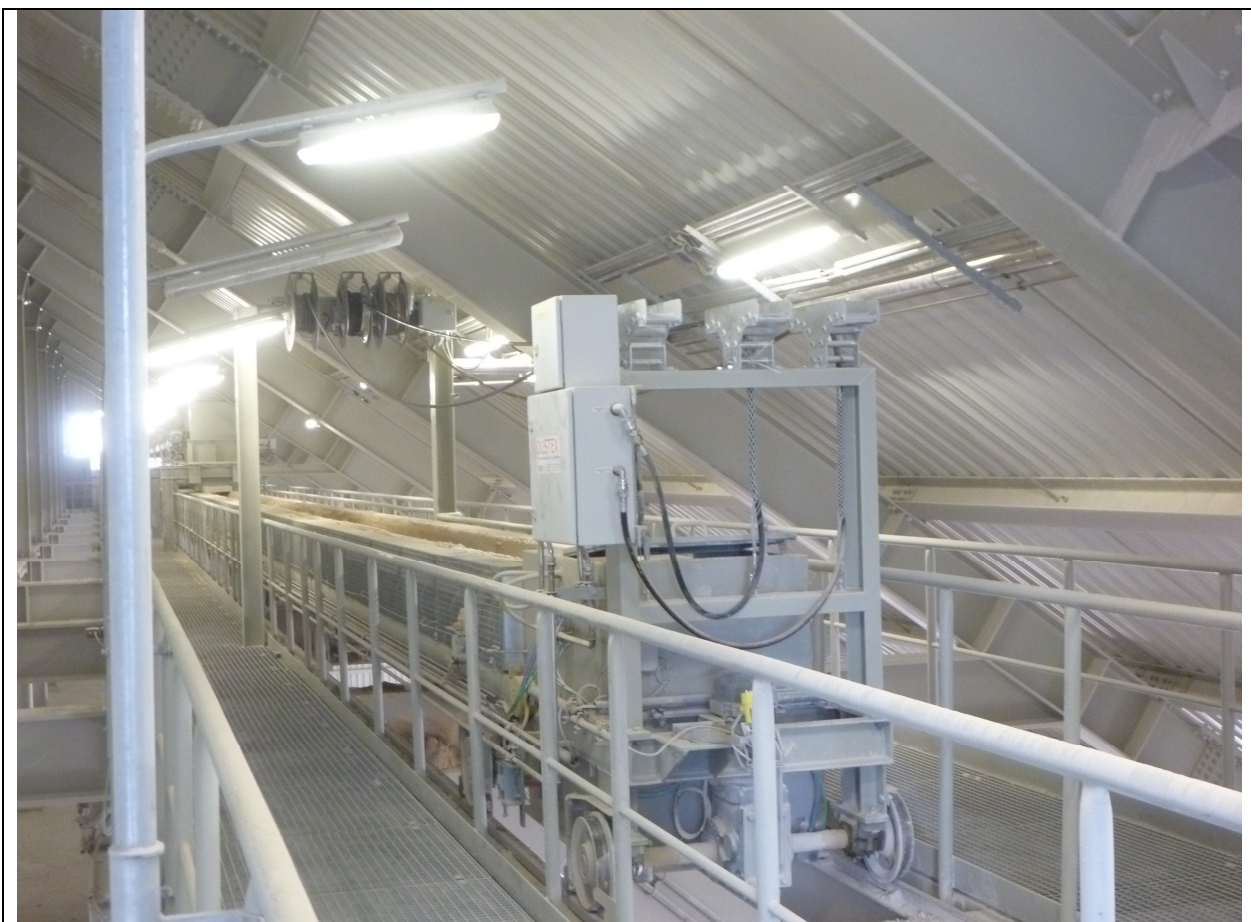
Verfahrbares Reversierband mit Ventilschrank und Medienzufuhr durch Schlauchtrommeln.
