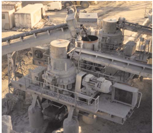
Anlage mit DUSTEX® im Einsatz
